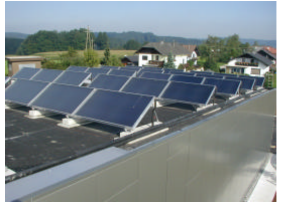
Solaranlage zur Warmwasserbereitung und Heizung
